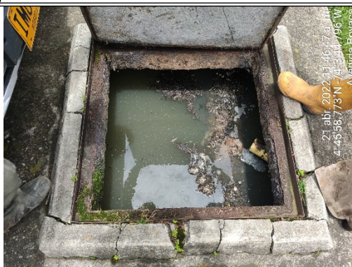
Foto No. 12. Tanque indeterminado antejardín casa 3 y 4 Conjunto Residencial El Trebol – PH
