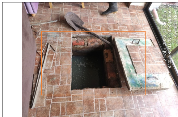
Foto No. 7. Caja de paso 1 casa 4, Conjunto Residencial El Trebol – PH Av. Kr 72 No. 175 – 65.
