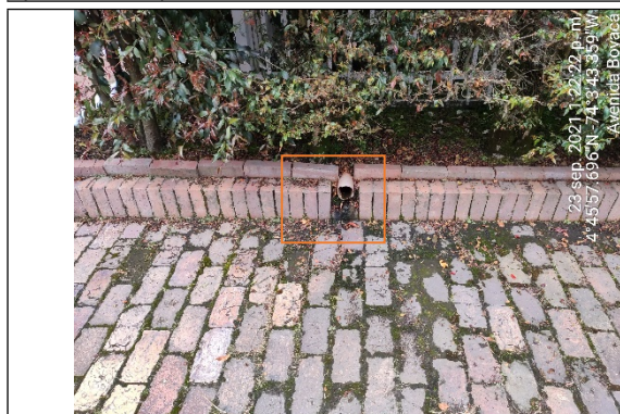
Foto No. 17. Tubería de aguas lluvias – ALL sobre calzada vehicular Conjunto Residencial El Trebol – PH.
