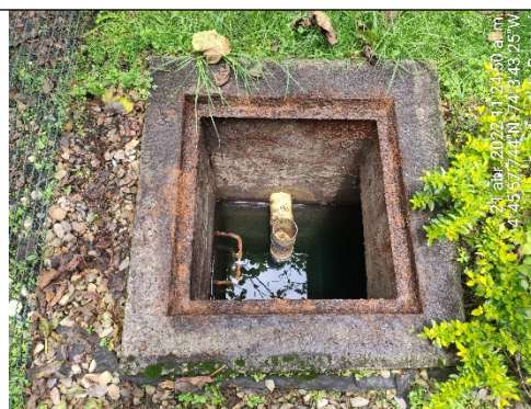
Foto No. 6. Pozo séptico, recamara final - Conjunto Residencial El Trebol – PH Av. Kr 72 No. 175 – 65.
