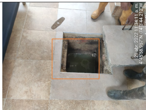
Foto No. 8. Caja de paso 2 casa 4, Conjunto Residencial El Trebol – PH Av. Kr 72 No. 175 – 65.
