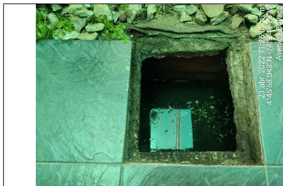
Foto No. 3. Caja de paso casa 1, Conjunto Residencial El Trebol – PH Av. Kr 72 No. 175 – 65.
