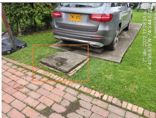
Foto No. 10. Tanque indeterminado antejardín casa 3 y 4 Conjunto Residencial El Trebol – PH.
